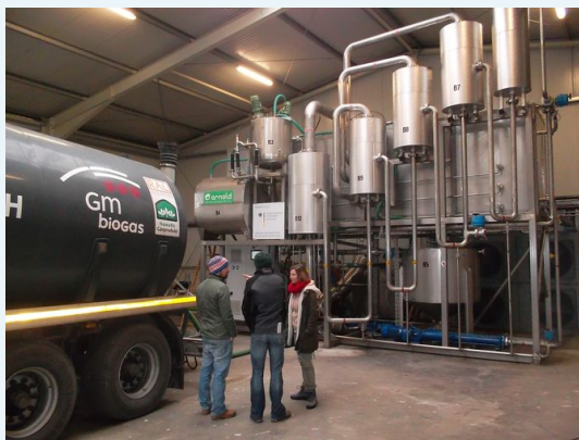
Großtechnischer Versuch zur Vakuumverdampfung von Gärresten
